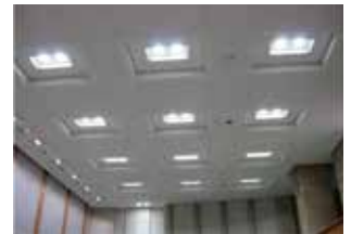
▲ 事務室高天井照明
