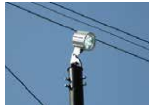
▲ 街灯照明設置部分
