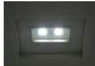
▲ 事務室高天井照明
