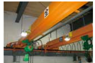
▲ クレーン照明
