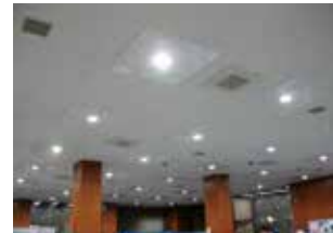
▲ 事務室高天井照明
