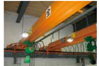
▲ クレーン照明
