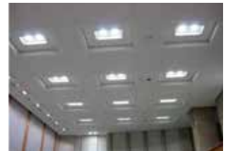
▲ 事務室高天井照明
