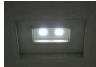
▲ 事務室高天井照明
